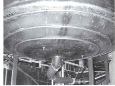
Dessous de cuve d'un extracteur sous laquelle on voit le serpentin chauffant.
